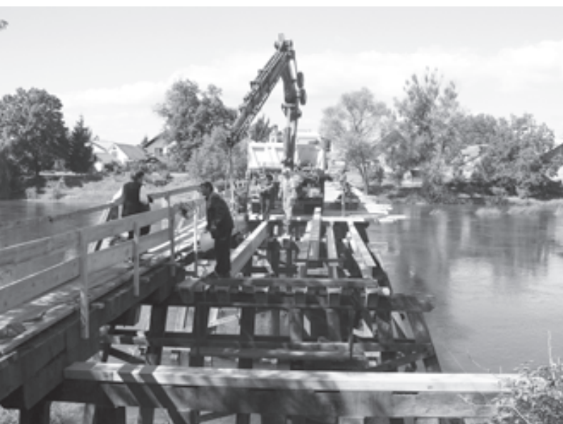
Porušeni most v sanaciji na istem mestu v letu 2006.
