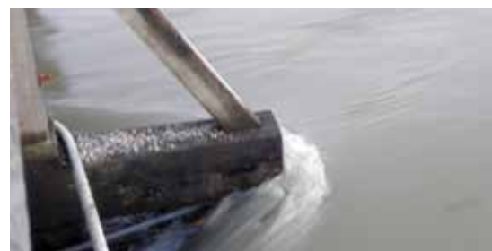
Voda je segala vse do vrha mostu
