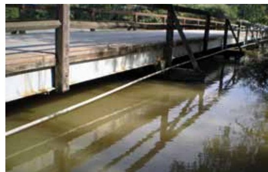
Voda je segala vse do vrha mostu
